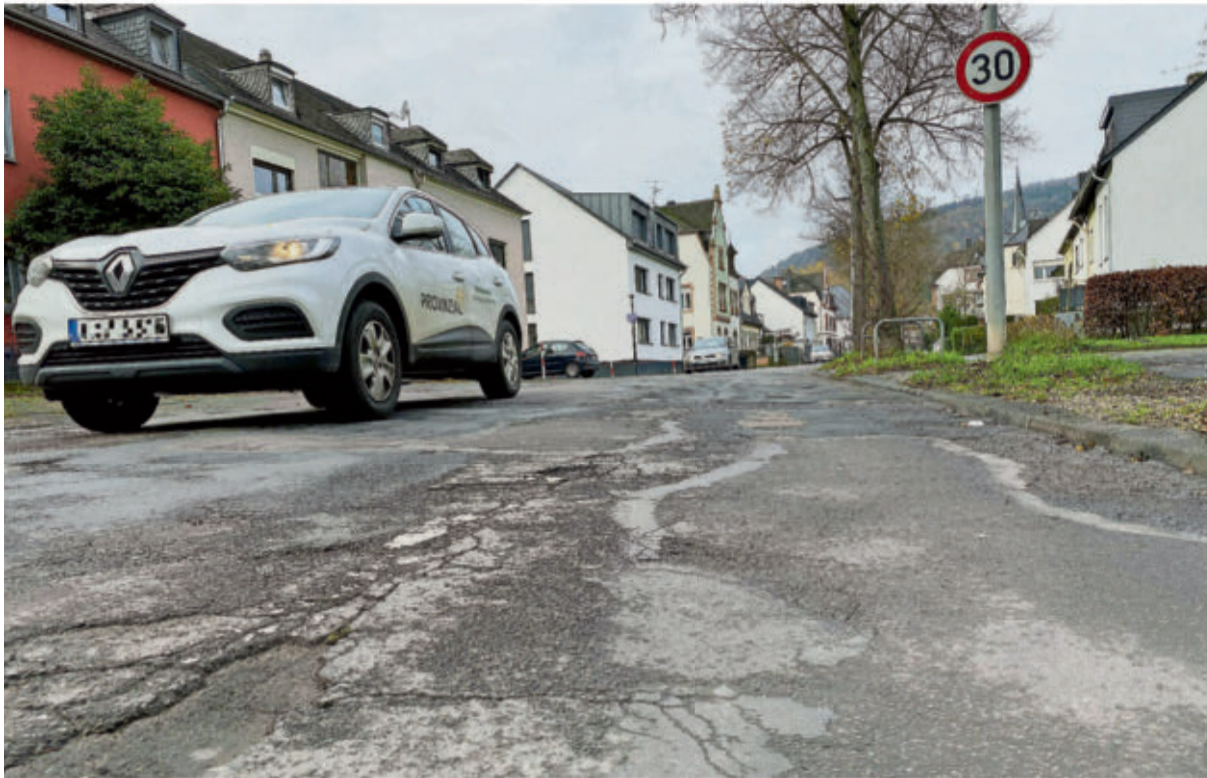
Die Eisenbahnstraße in Euren ist in einem sehr schlechten Zustand. Die Sanierung ist nun beschlossene Sache. Für die Gehwege müssen auch die Grundstückseigner im Stadtteil zahlen.
