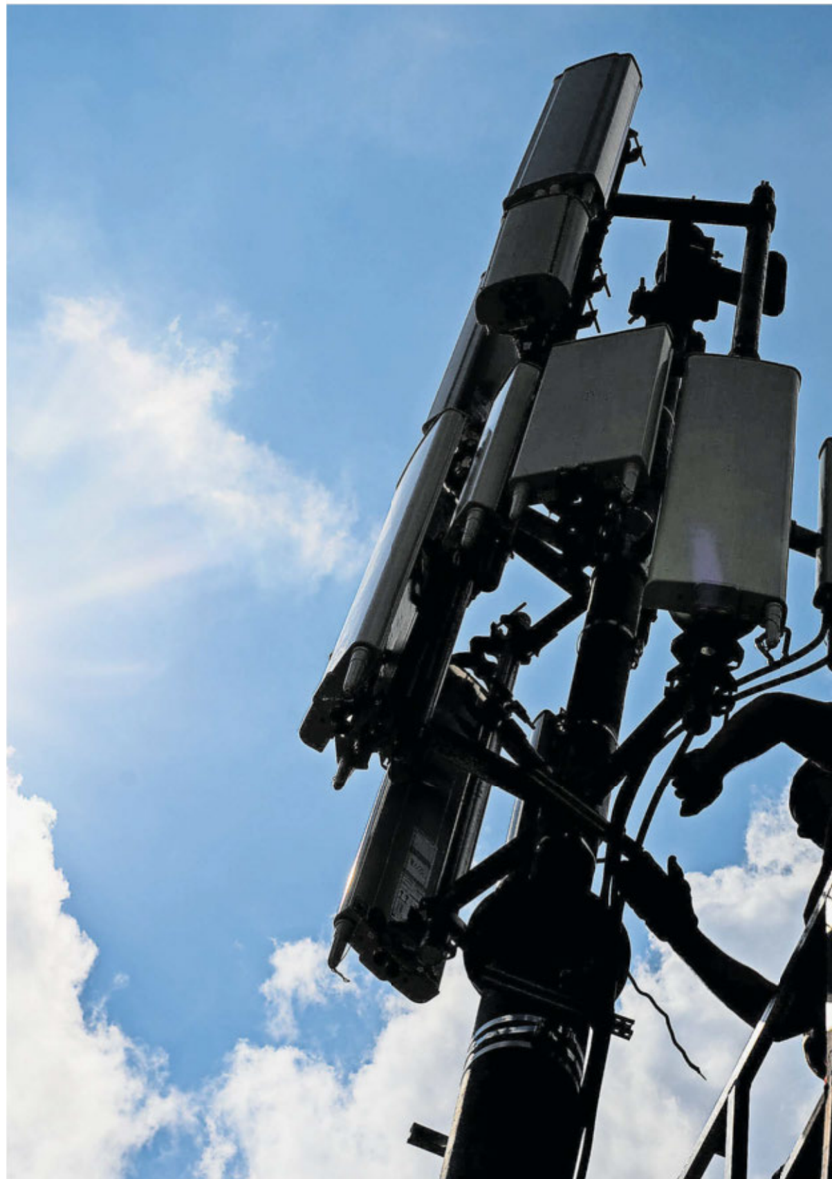
Die Zahl der Sendemasten nimmt wegen des 5G-Ausbaus beständig zu. In vielen Fällen werden bestehende Anlagen erweitert.
