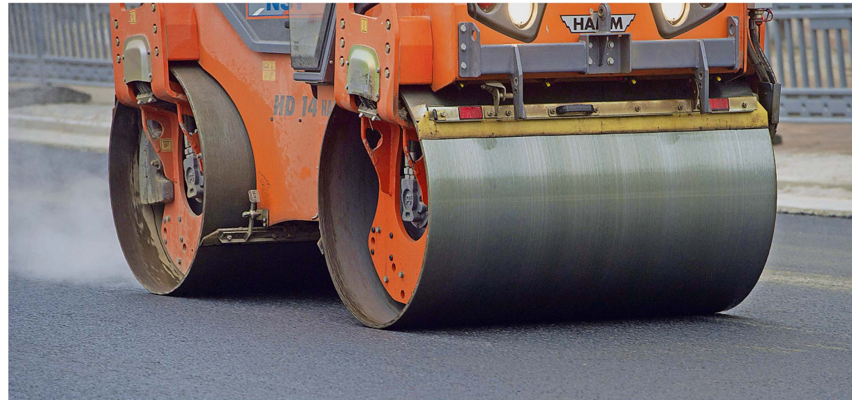
Wenn Straßen repariert werden, bitten die Kommunen in Rheinland-Pfalz die Anlieger zur Kasse. Flossen oft hohe Einmalzahlungen, soll sich das System ändern. Steuerzahlerbund und Eigentümern reicht das nicht.
